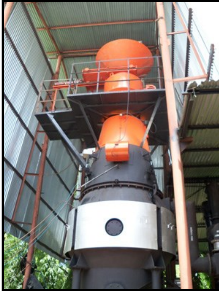
Figura 16. Gasificador de biomasa de 250 kW. Fuente: http://www.inti.gov.ar
