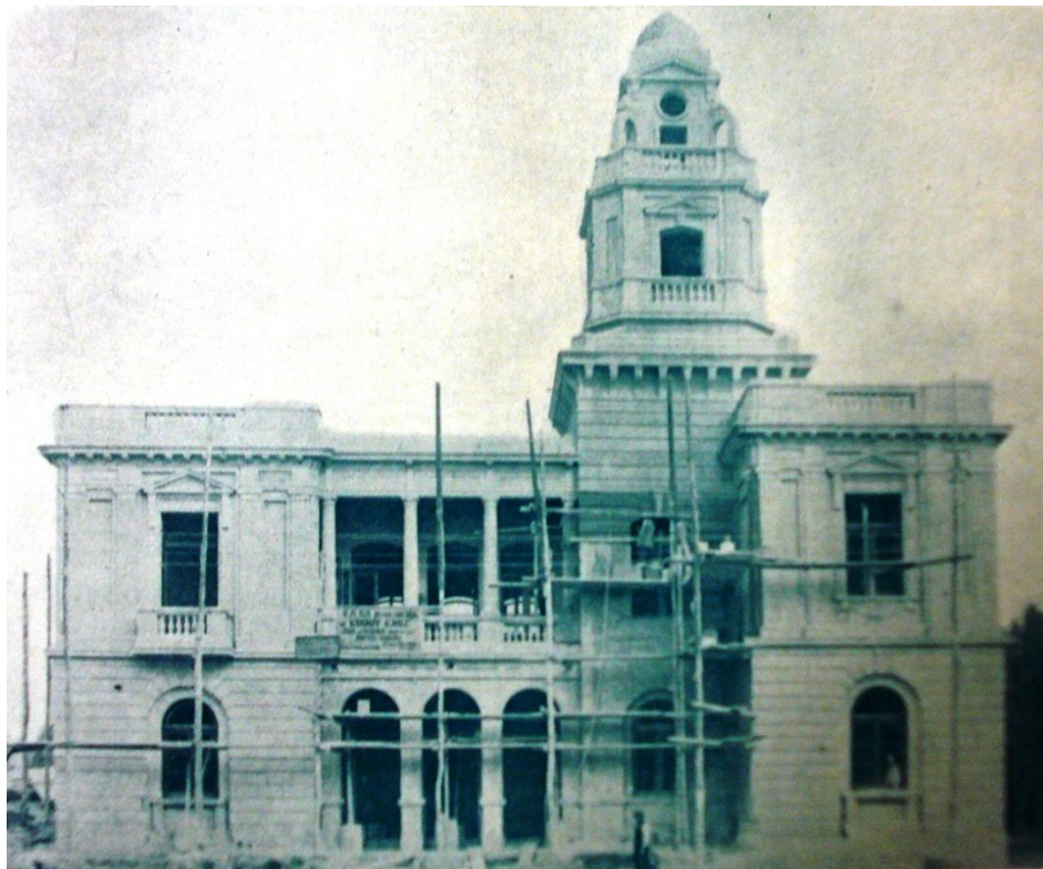
Construcción de la Comisaría 7ª. Frente principal. Provincia de Mendoza. Dos años de ministerio. Gobierno del Dr. Alejandro Orfila. Memoria presentada por el Ministro de Industrias y Obras Públicas, Dr. José E. Aguilar a la Honorable Legislatura de Mendoza. Obras Públicas, 1926-1927. Colombatti & Cía. Ltda., Buenos Aires, 1928. Tomo 2.
