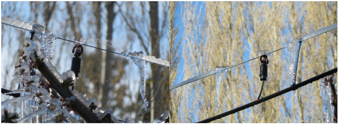
Figura 35: Estructura de soporte cubierta de hielo luego de un evento de helada
